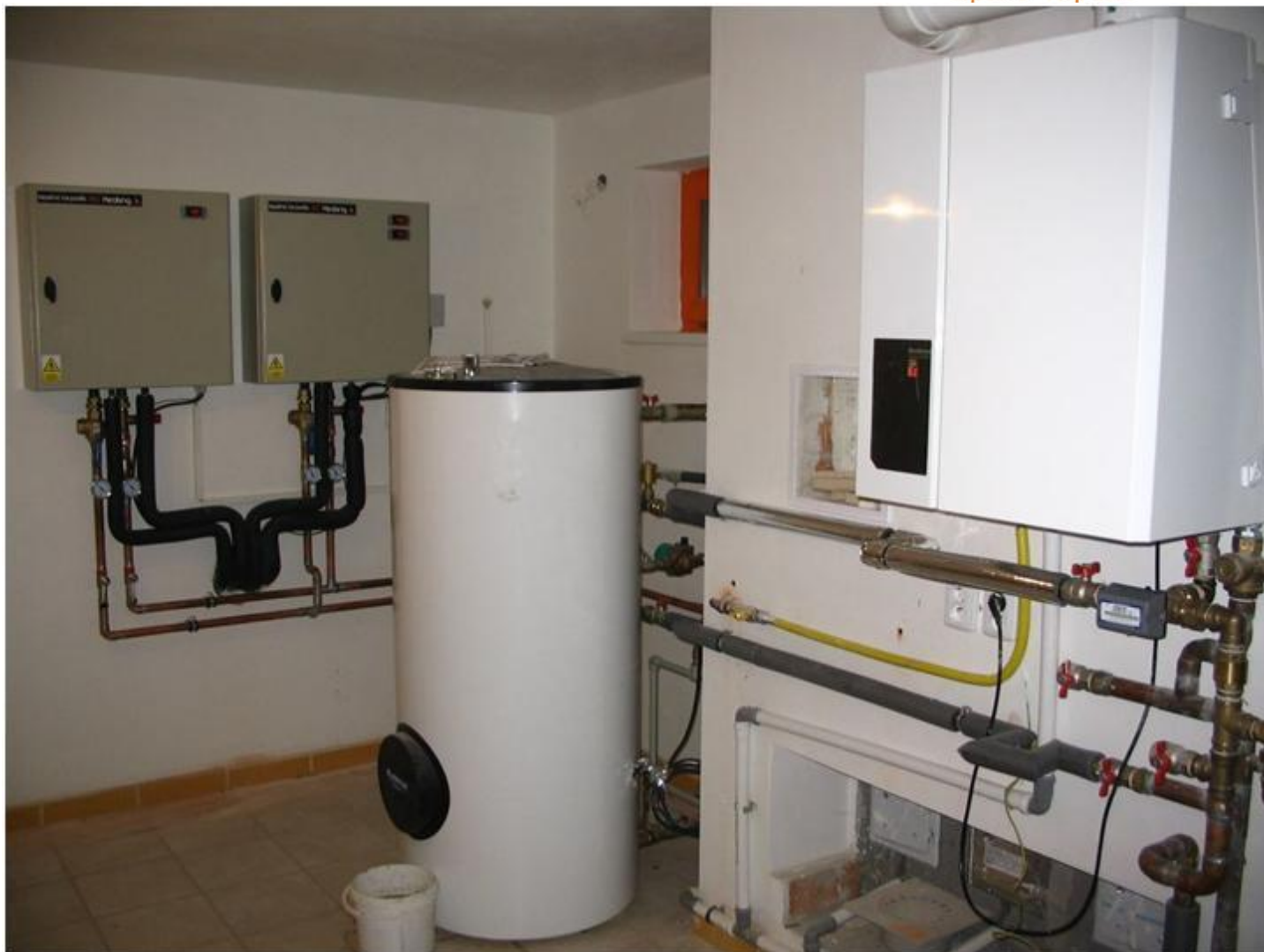
Vnitřní jednotka s plynovým kotlem a bojlerem
