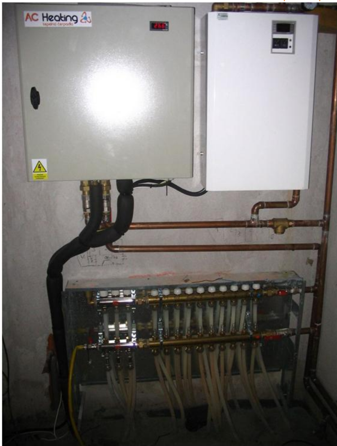
Vnitřní jednotka s elektrokotlem
