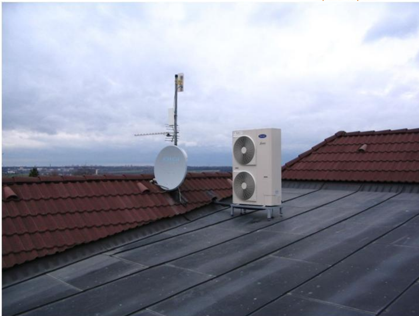
Venkovní jednotka na střeše 2
