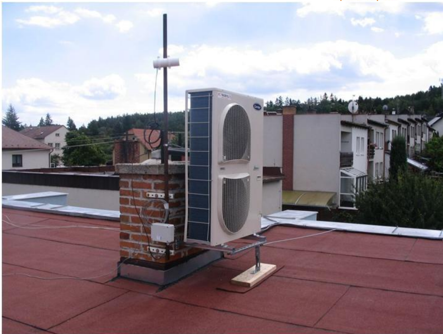
Venkovní jednotka na střeše 1
